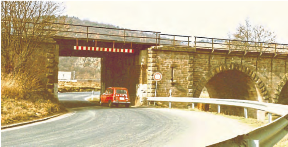
Die alte Doppelbrücke über B 48 und Alsenz (rechts) aus Richtung Ortslage um 1975.
